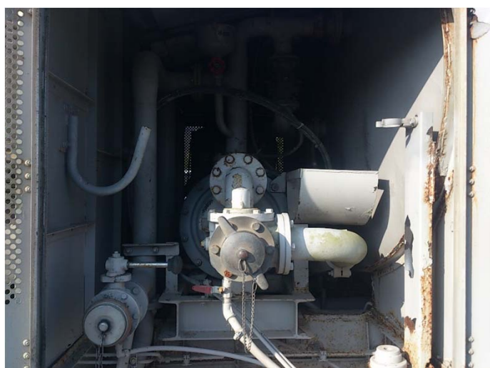
⑥散水用動力ポンプ
