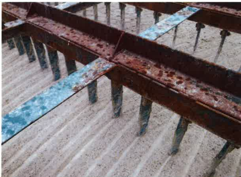
○フレーム拡大 腐食著しい
