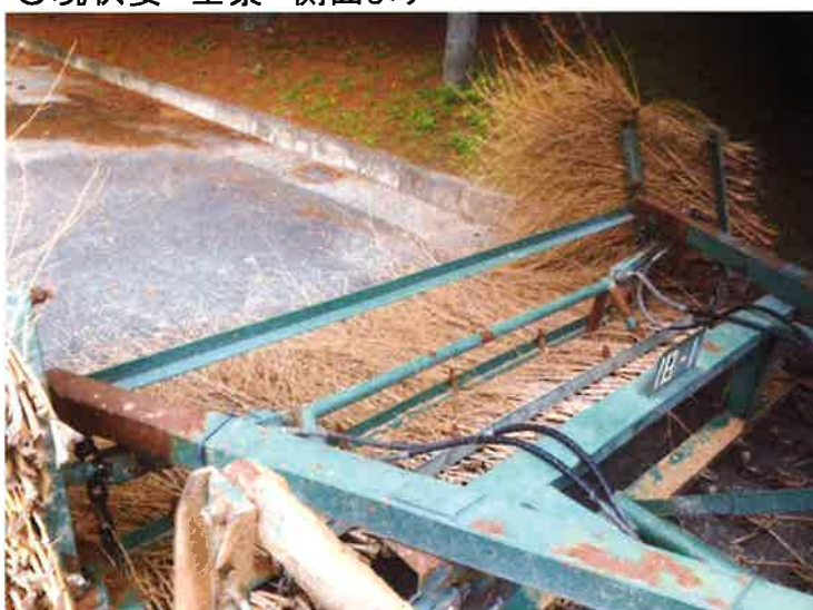
○フレーム拡大 腐食著しい。油圧ホース劣化。
