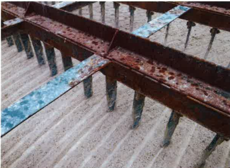
○フレーム拡大 腐食著しい
