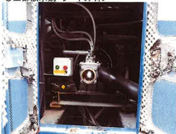
○真空ポンプクラッチ故障
